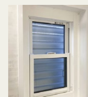
内窓を取り付けたジャロジー窓
