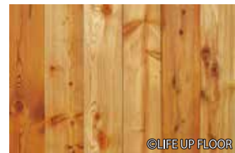
揮発物質の量は樹種により異なり、広葉樹よりも針葉樹の方が多くとされる。写真は針葉樹の中でも発生量の少ないカラマツ
